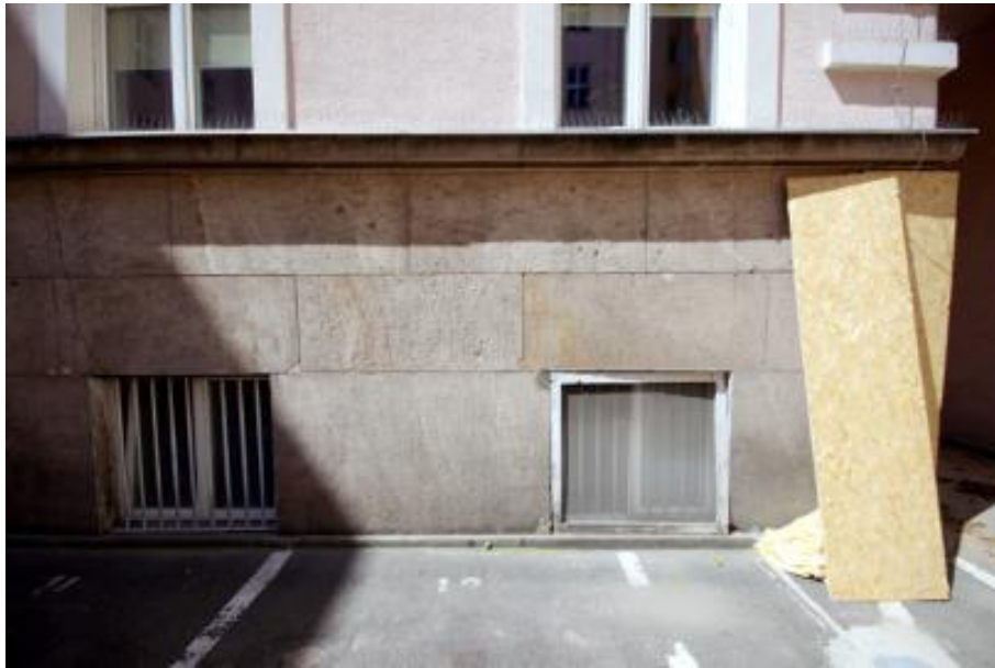
25. Cokół na elewacji budynku na dziedzińcu nr 2 Na tym cokole widać wiele uszkodzeń spowodowanych rykoszetami kul z karabinów maszynowych
