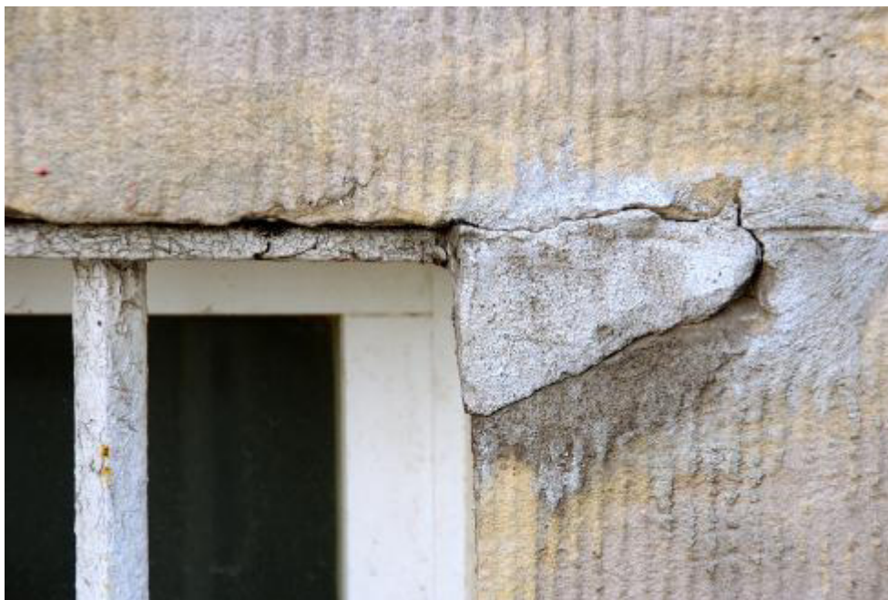
47. Fragment cokołu z piaskowca na dziedzińcu nr 4 z wykruszonym przez korodującą żelazną kratę narożnikiem kamiennej płyty
