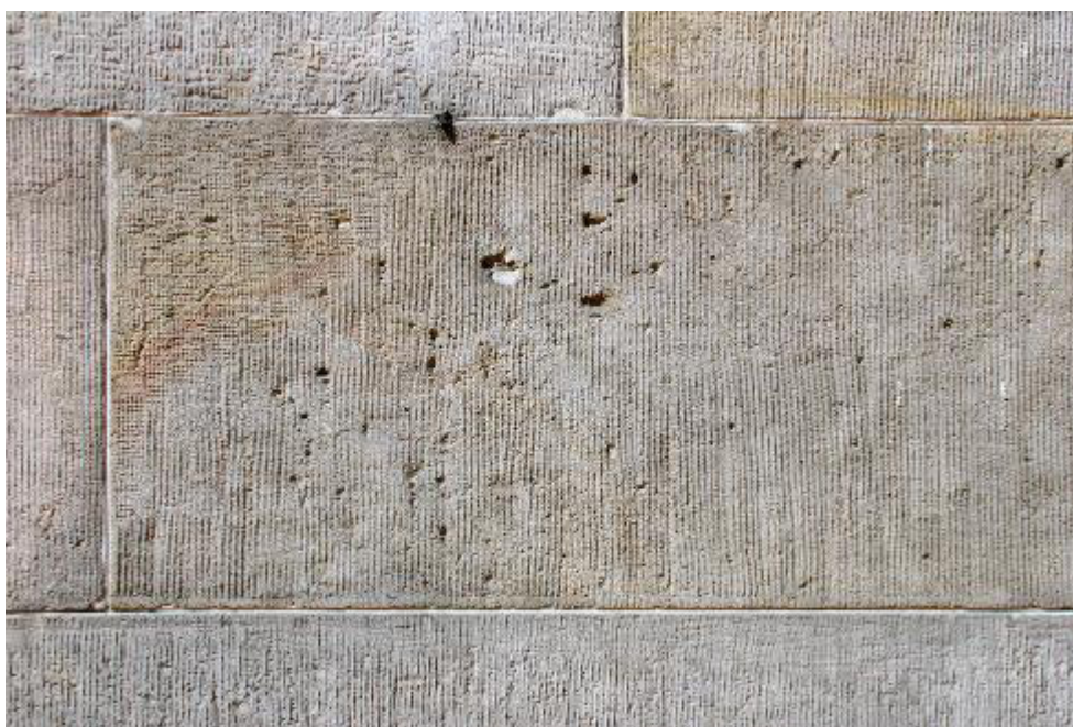
46. Fragment cokołu z piaskowca na zachodniej elewacji dziedzińca nr 4 z widocznymi śladami uszkodzeń mechanicznych, wyraźnie odmiennych niż ślady po postrzałach
