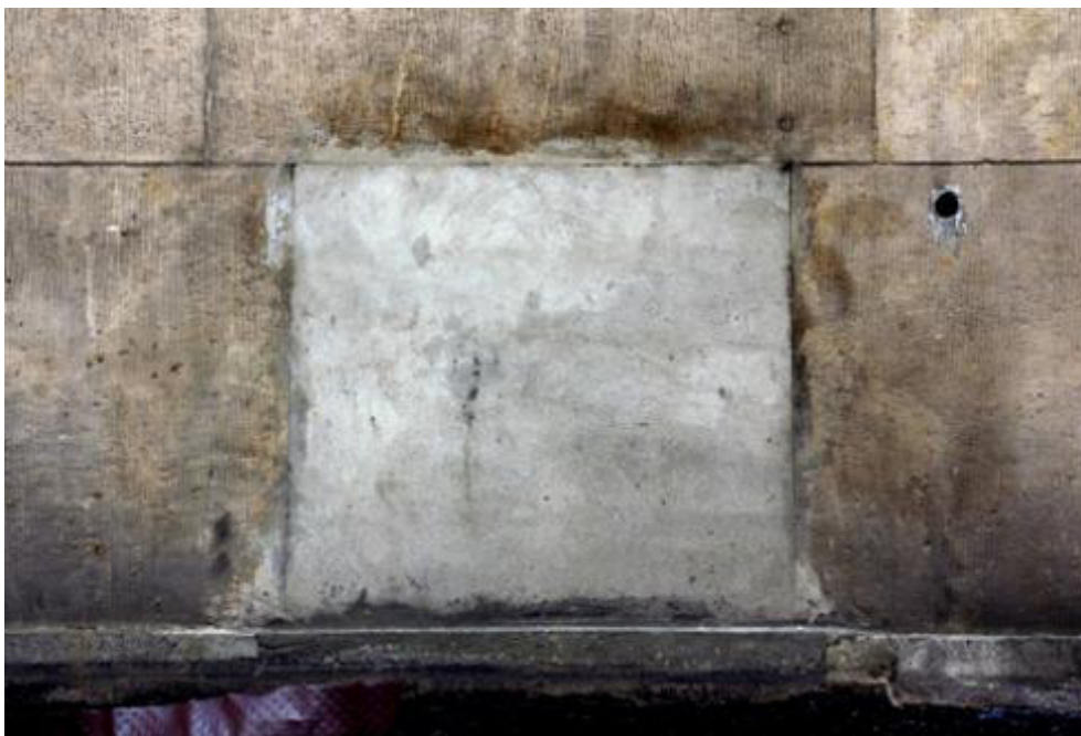
59. Widok zamurowanego okna, którego blendę należy Wycofać od lica kamiennego cokołu i na nowo zaaranżować
