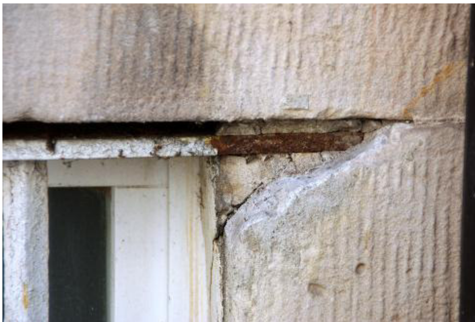
57. Kolejny fragment cokołu z piaskowca zniszczony przez korodującą kratę
