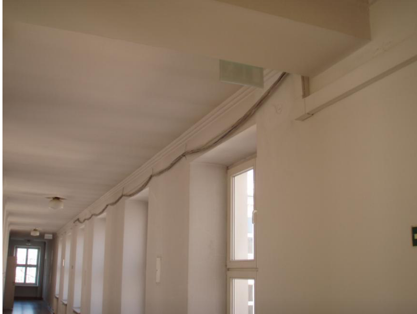
Fot. 19 widok części sufitów oraz instalacji przewidzianej do wkucia w ścianę lub wprowadzenia w koryta z PCV
