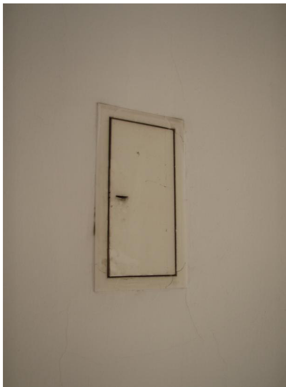
Fot. 15 widok drzwiczek rewizyjnych do wymiany na nowe
