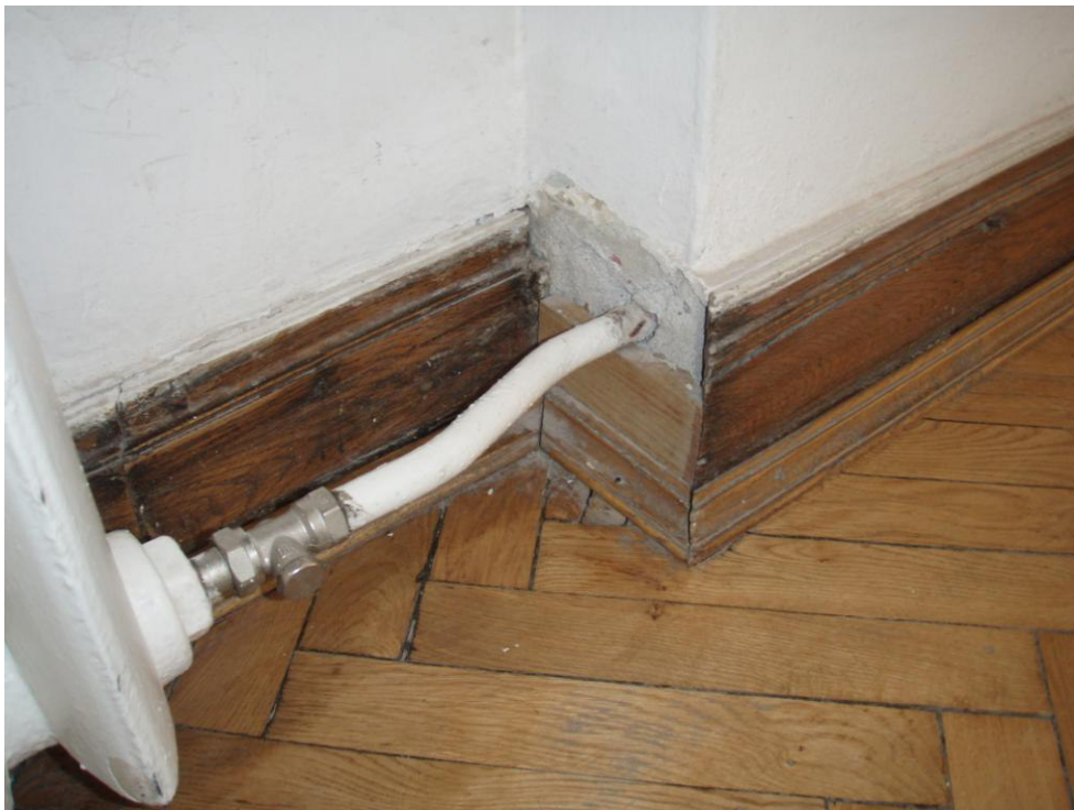
Fot. 4 widok ubytku cokołu w strefie podokiennej korytarza
