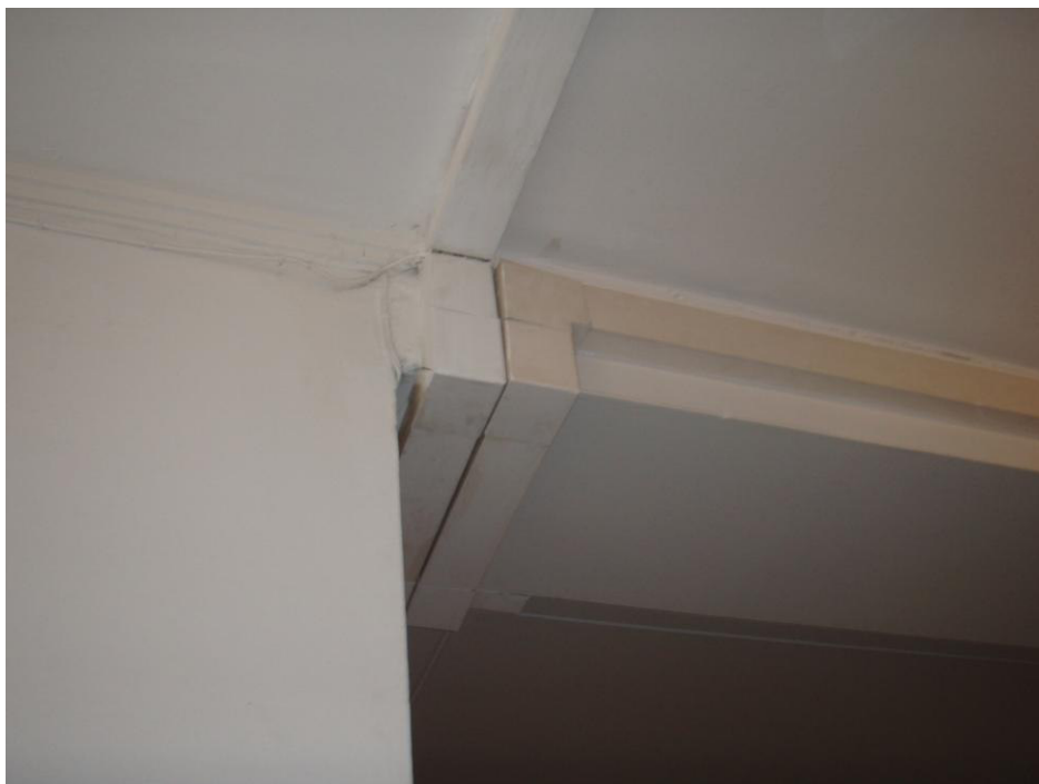
Fot. 11 widok instalacji teletechnicznych do wkucia w ścianę
