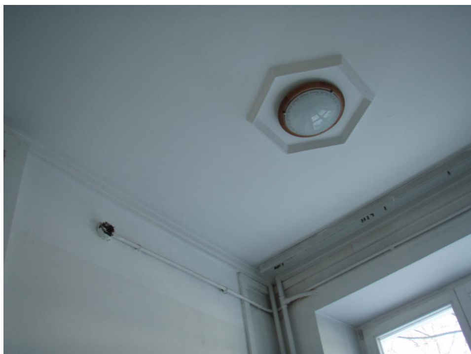
Fot. 14 widok zniszczonych rozet przeznaczonych do renowacji (Ip.)
