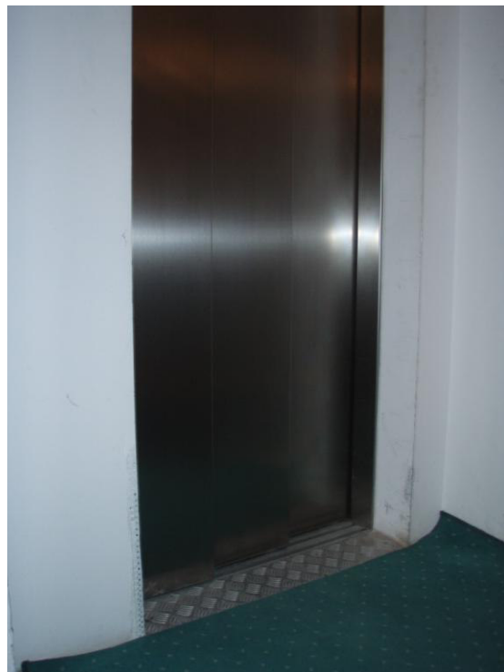
Fot. 8 widok ubytków w ścianie przy wejściu do windy
