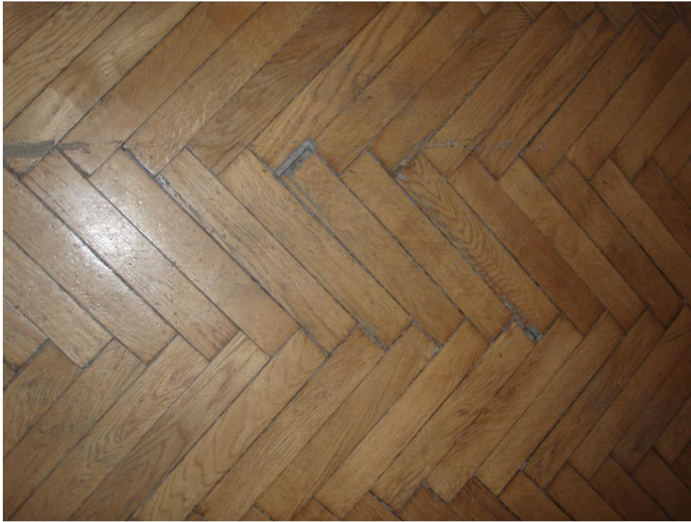
Fot. 3 widok zniszczonej posadzki w przed klatką
