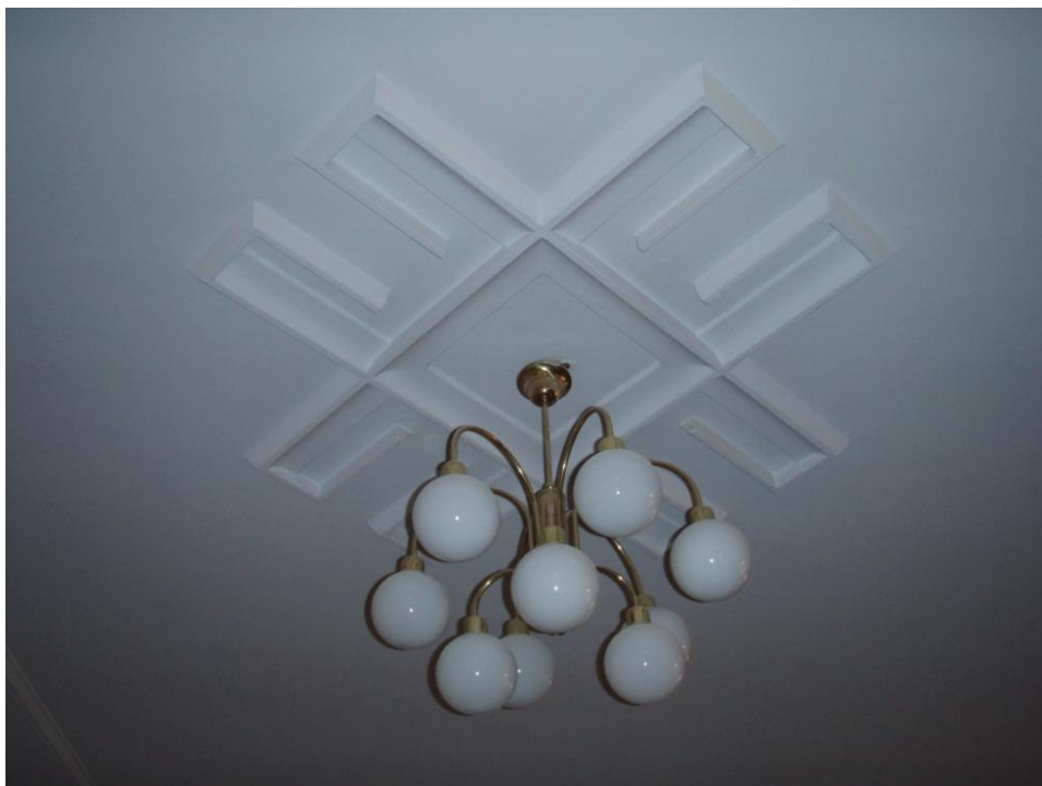
Fot. 13 widok zniszczonych rozet przeznaczonych do renowacji
