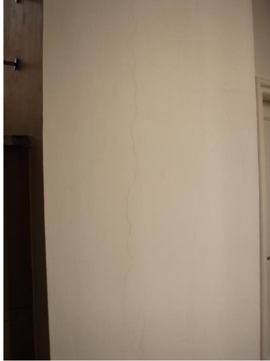
Fot. 7 widok popękanej ściany w strefie wewnętrznej korytarza
