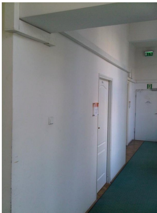
Fot. 22 widok instalacji przewidzianej do przełożenia (korytarz I piętra)
