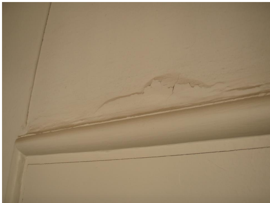
Fot. 6 widok zniszczonej ściany na drzwiach do pokoju
