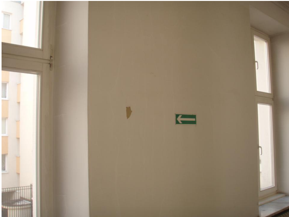
Fot. 5 widok ubytków w ścianie w strefie okiennej korytarza
