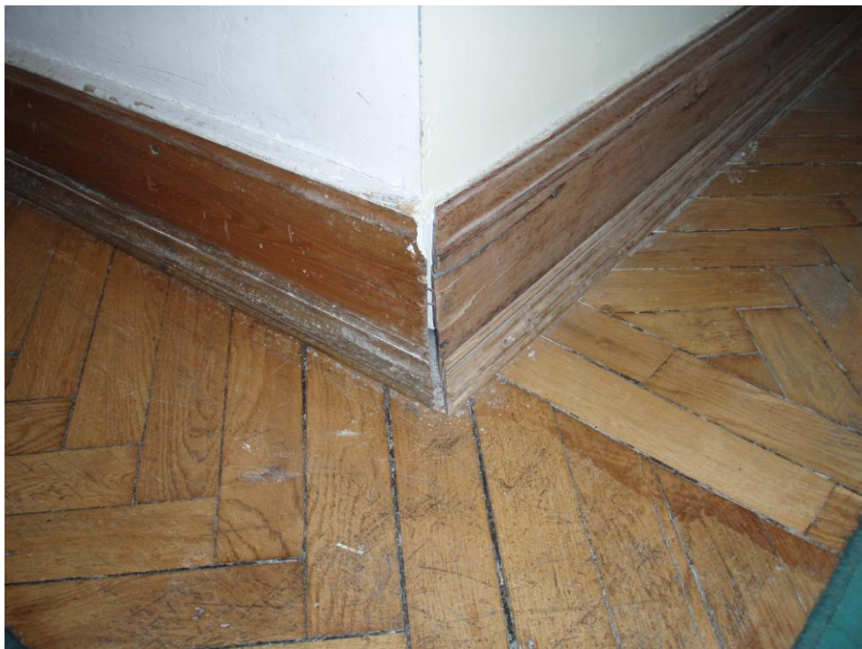
Fot. 1 widok zniszczonej posadzki z cokołem
