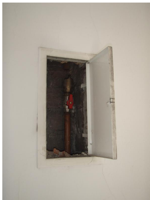
Fot. 16 widok drzwiczek rewizyjnych do wymiany
