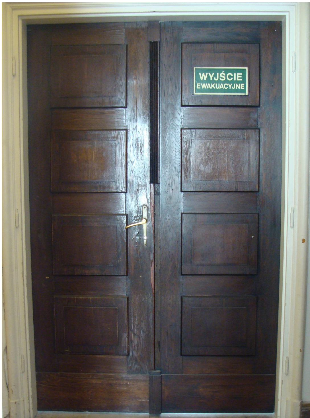
Drzwi na boczną klatkę schodową, widok od strony korytarza, na pierwszym planie, widoczna futryna z fragmentami zawiasów po zlikwidowanych białych drzwiach – stan 2013 r.
