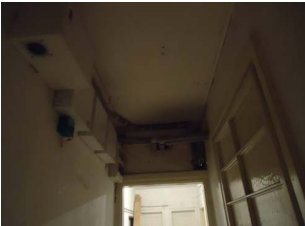
Pom. „-1a01” Rozdzielnica KD i centralki alarmowe – będą obudowane w ramach robót budowlanych - obudowa z możliwością dostępu do rozdzielnic i centralek.
