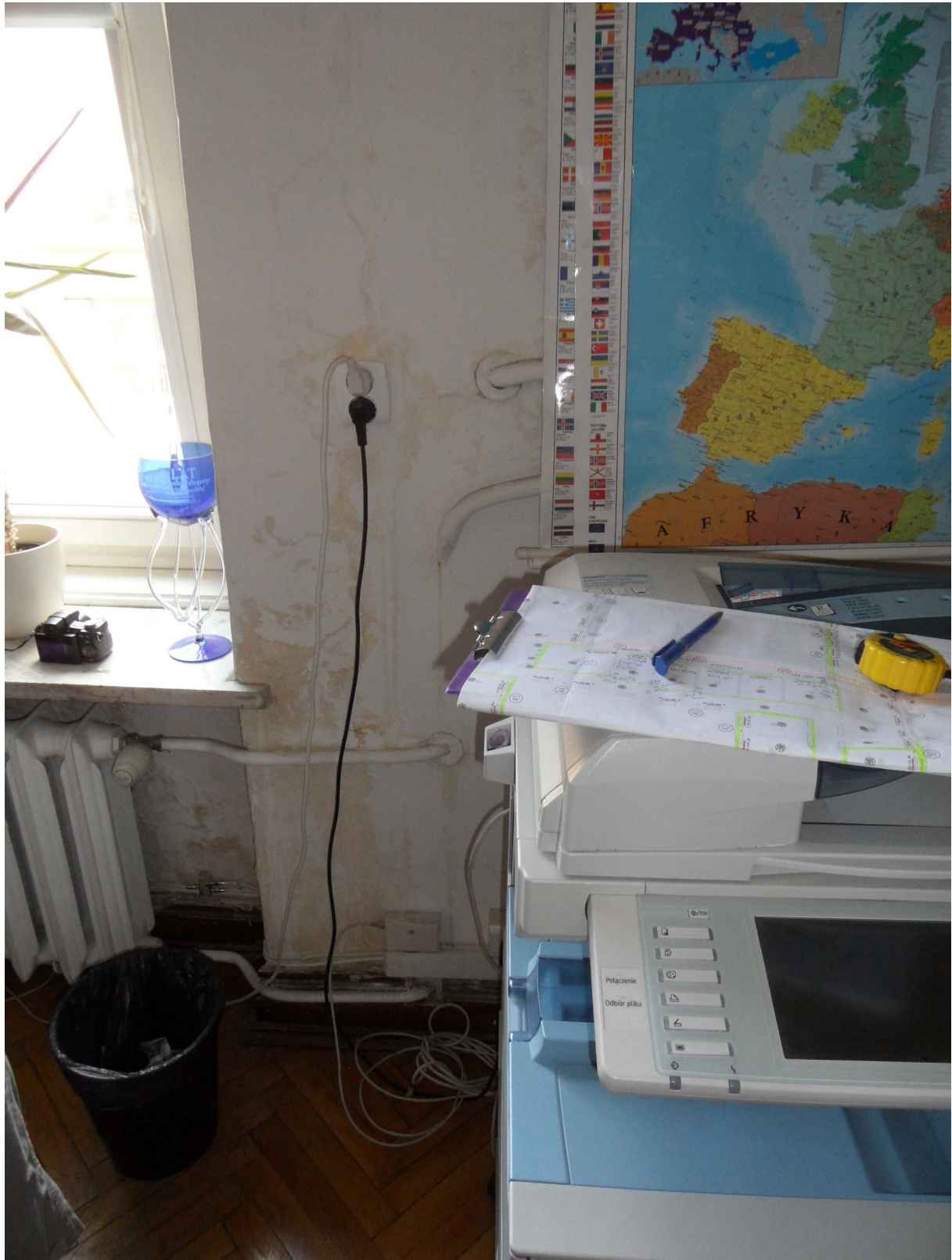
Zdjęcie nr 7. Pomieszczenie nr 315, zły stan techniczny powłok malarskich i tynków – zawilgocenia, zacieki i odparzenia.
