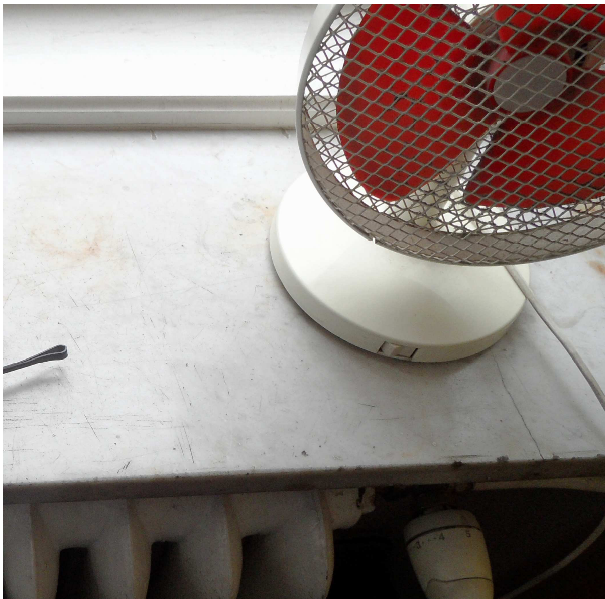
Zdjęcie nr 16. Pomieszczenie nr 337, ubytki, rysy oraz zabrudzenia parapetu marmurowego.
