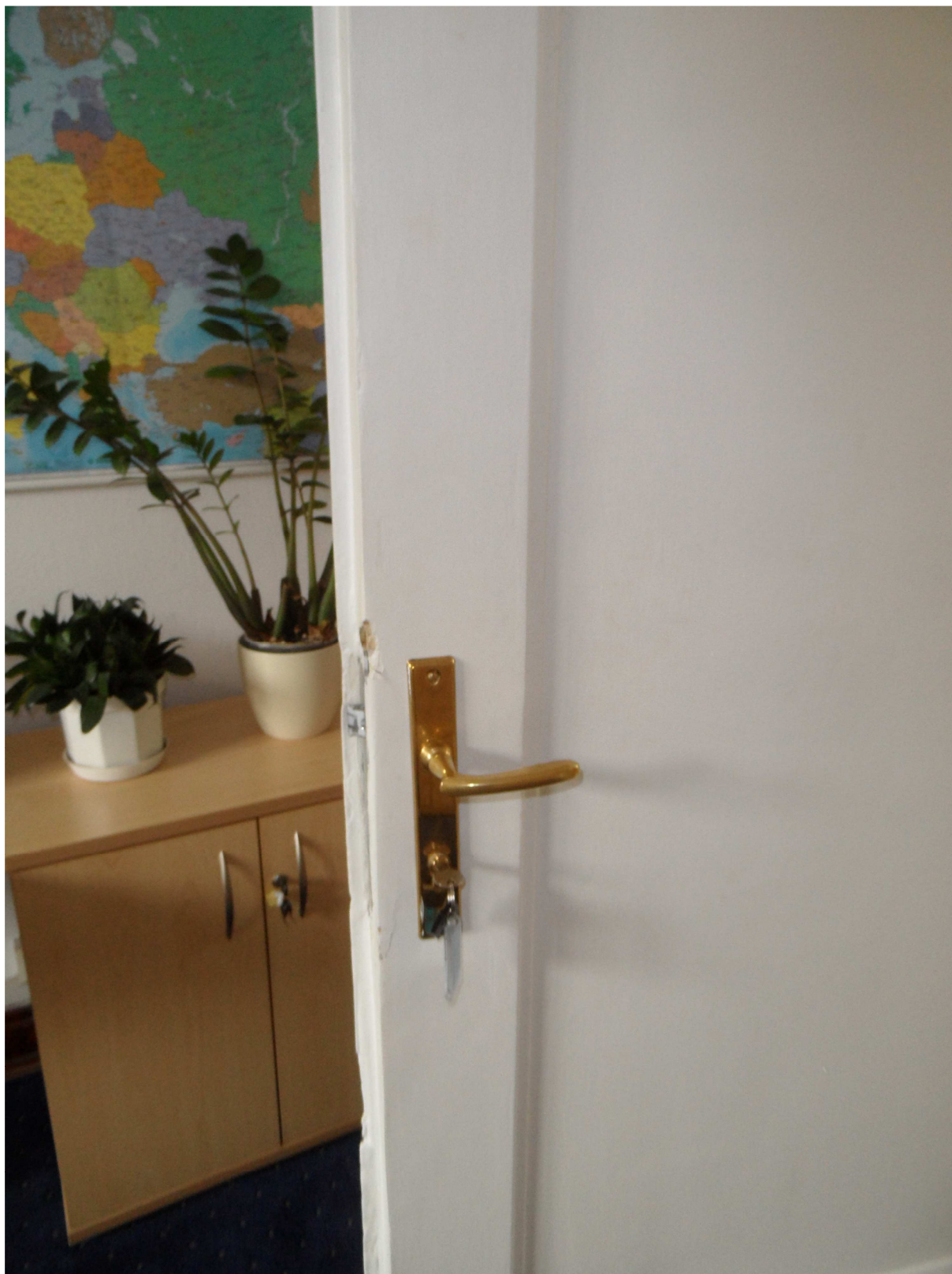
Zdjęcie nr 18. Pomieszczenie nr 372, drzwi wejściowe oryginalne, widoczne ubytki skrzydła drzwi.
