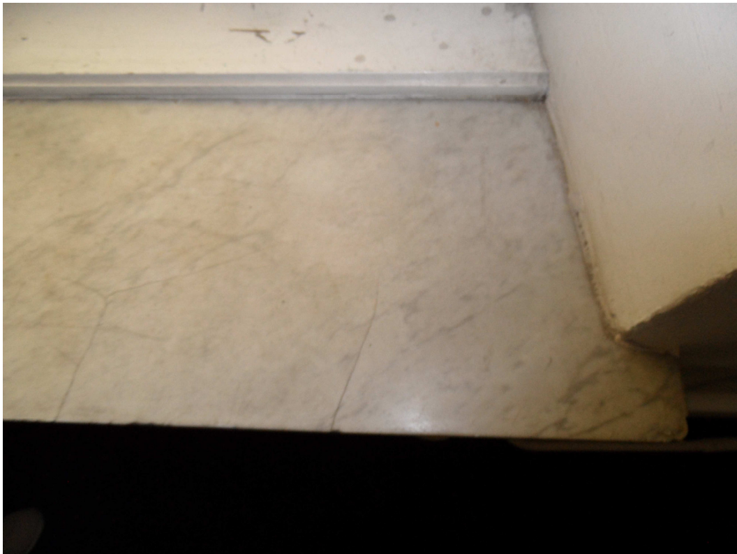
Zdjęcie nr 15. Pomieszczenie nr 369, ubytki oraz rysy parapetu marmurowego.
