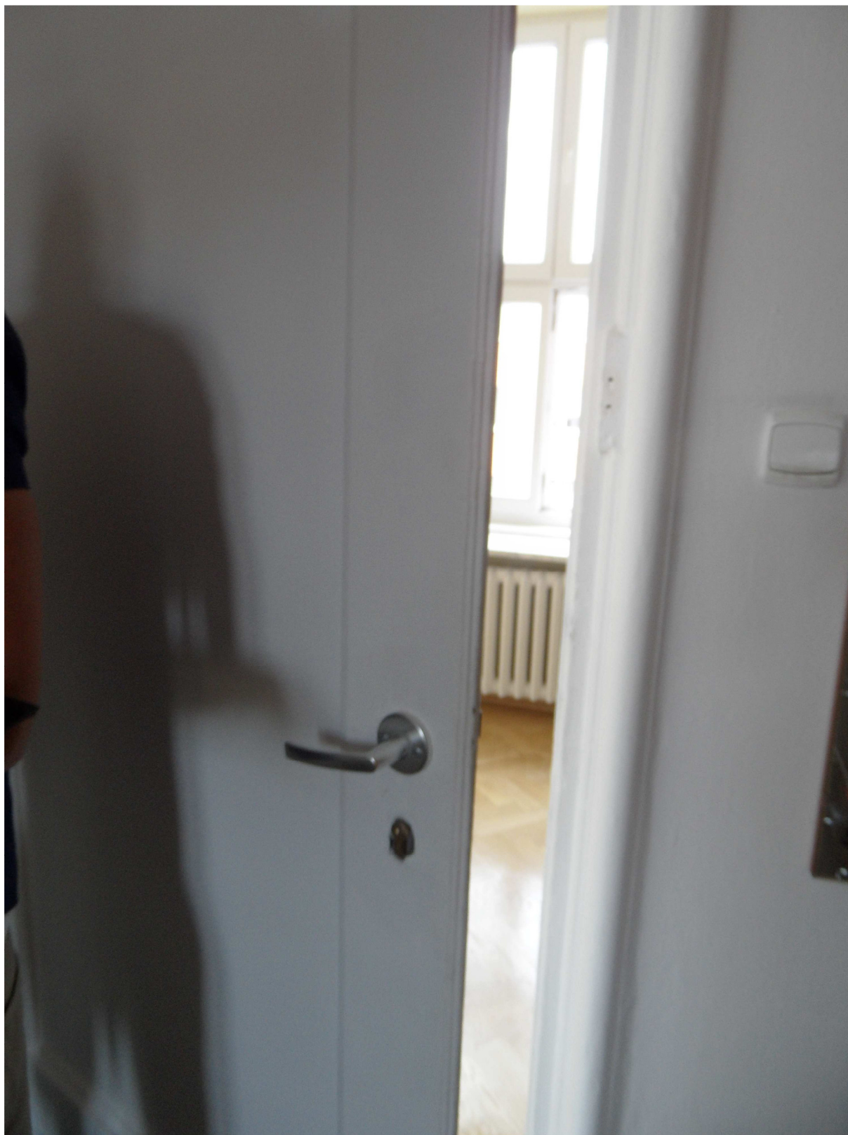
Zdjęcie nr 19. Pomieszczenie nr 346, drzwi wejściowe oryginalne, wtórna klamka oraz zamek, nie odpowiadające klasycznemu wzorowi.
