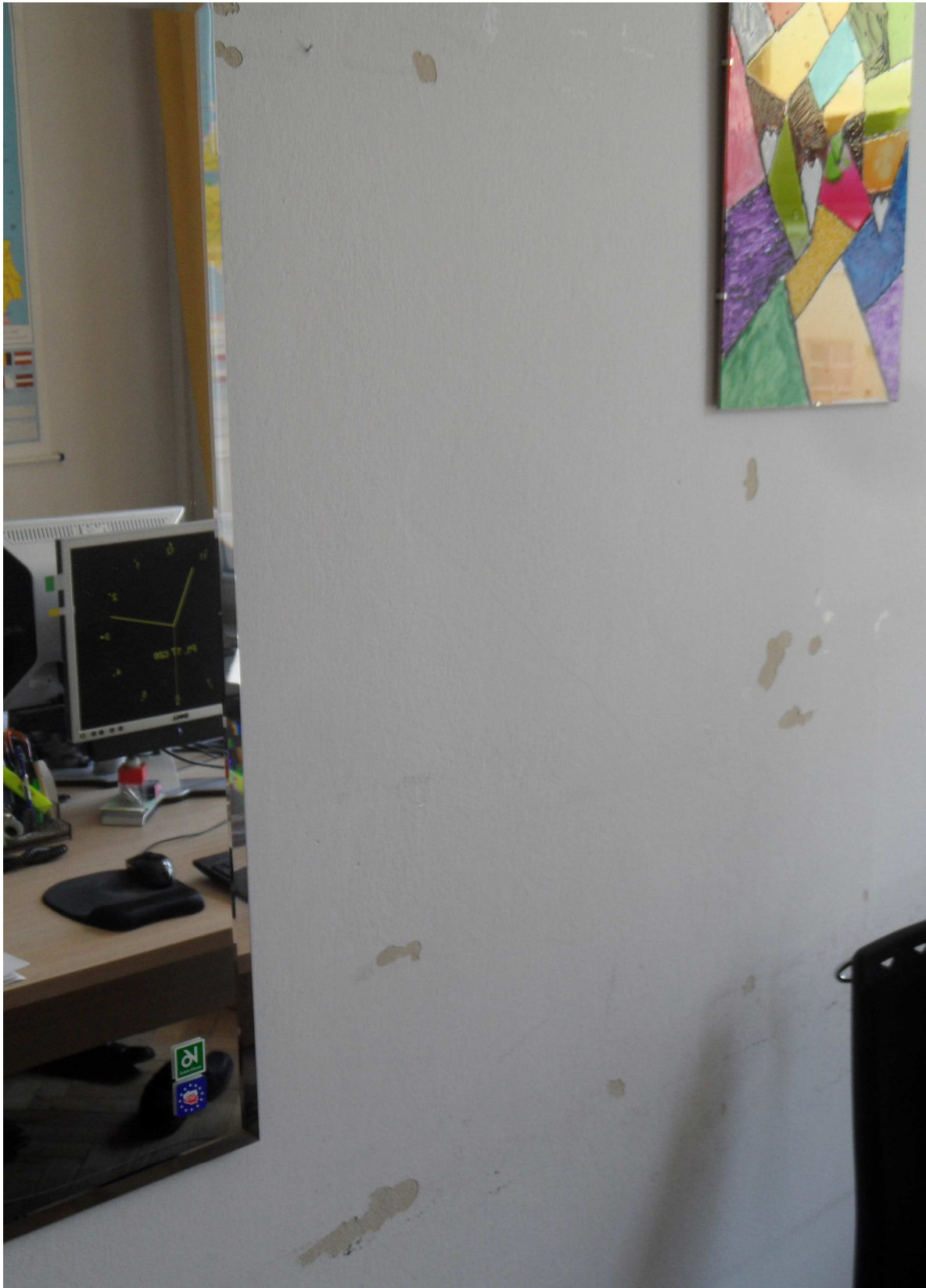
Zdjęcie nr 11. Pomieszczenie nr 323, ubytki i zabrudzenia powłok malarskich.
