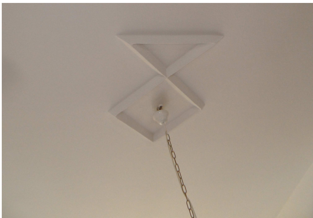
Zdjęcie nr 13. Pomieszczenie nr 347, rozeta sufitowa, nie kompletna.
