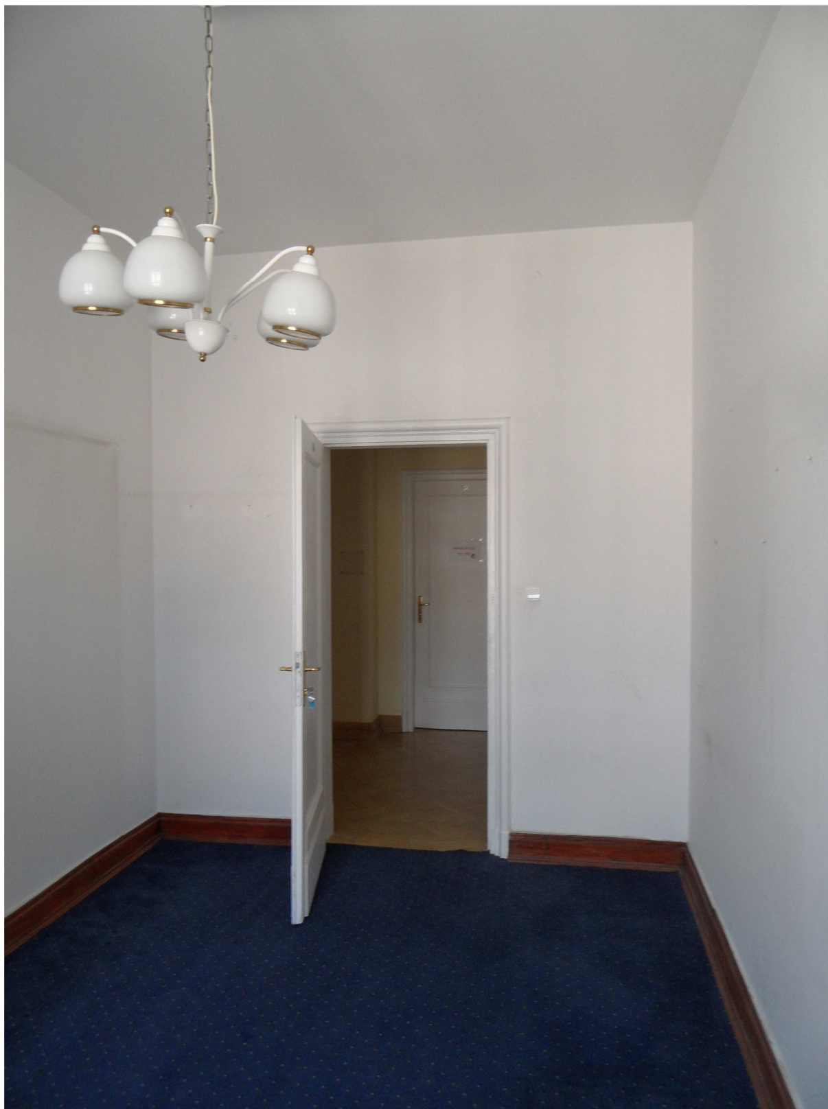
Zdjęcie nr 5. Pomieszczenie nr 360, wykładzina dywanowa, klejona do parkietu drewnianego na całej powierzchni pomieszczenia, wykładziny lokalizowane z uwagi na zły stan techniczny połogi – pylenie pyłem lepikowym przez szczeliny między deskami.
