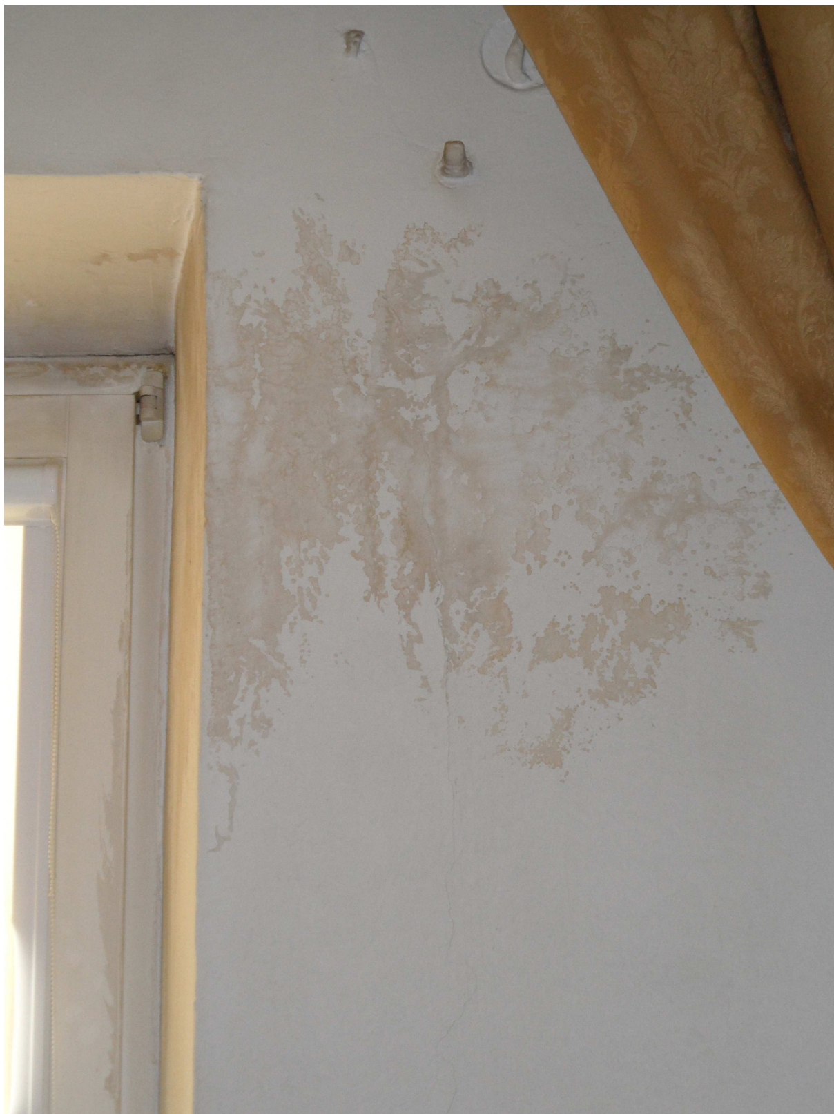
Zdjęcie nr 8. Pomieszczenie nr 328, zły stan techniczny powłok malarskich i tynków – zawilgocenia, zacieki i odparzenia.
