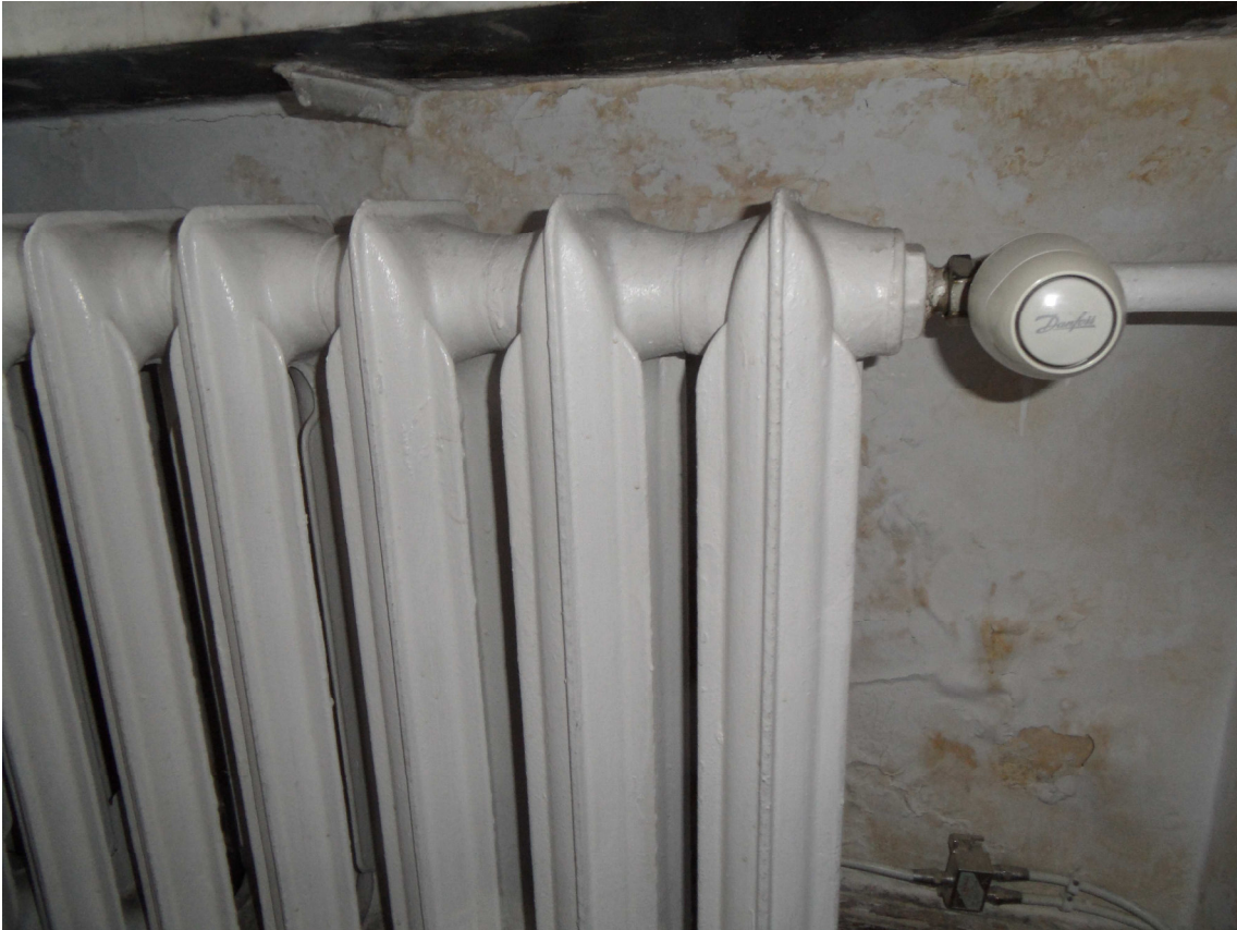
Zdjęcie nr 9. Pomieszczenie nr 315, zły stan techniczny powłok malarskich i tynków – zawilgocenia, zacieki i odparzenia.
