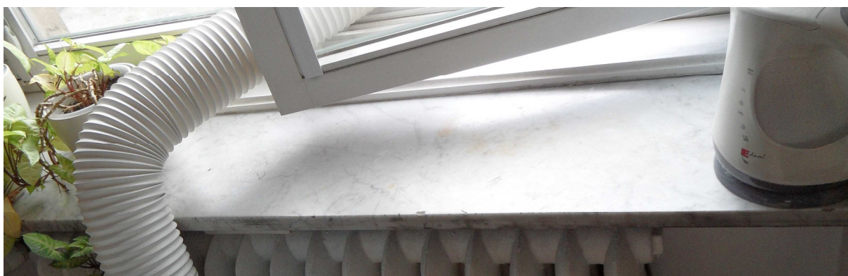
Zdjęcie nr 17. Pomieszczenie nr 372, ubytki, rysy oraz zabrudzenia parapetu marmurowego.
