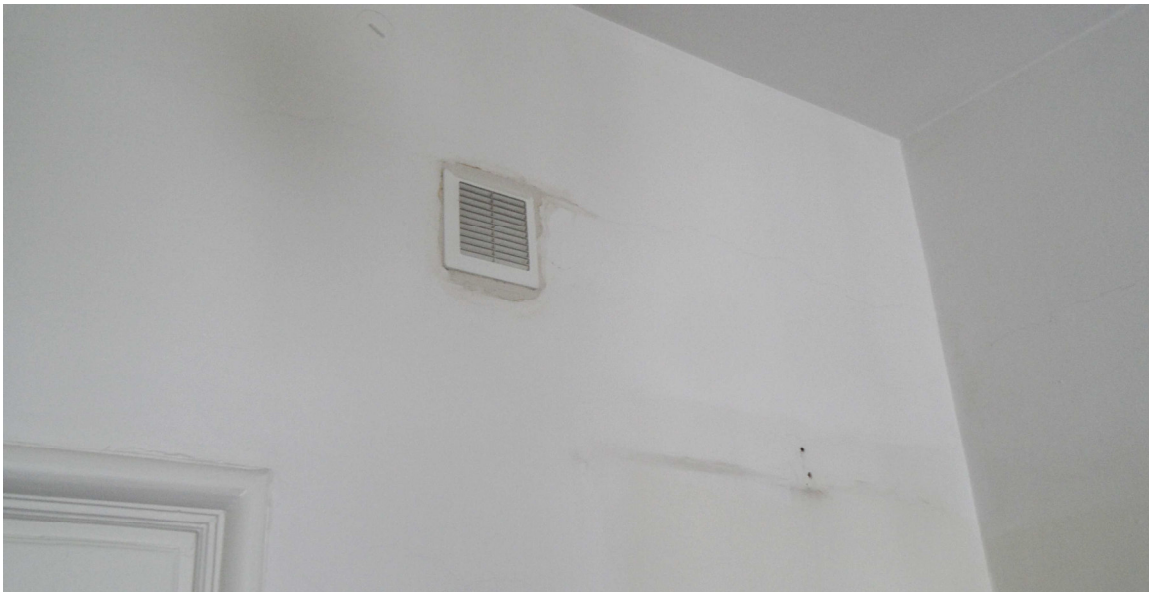
Zdjęcie nr 10. Pomieszczenie nr 327, zabrudzenie powłok malarskich, ubytki tynku, wtórna kratka wentylacyjna.
