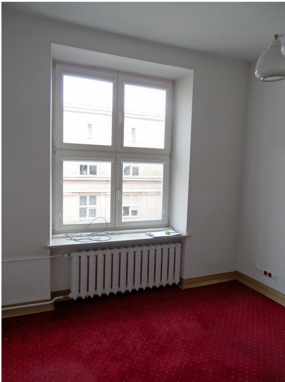
Zdjęcie nr 6. Pomieszczenie nr 312, wykładzina dywanowa, klejona do parkietu drewnianego na całej powierzchni pomieszczenia, wykładziny lokalizowane z uwagi na zły stan techniczny połogi – pylenie pyłem lepikowym przez szczeliny między deskami.
