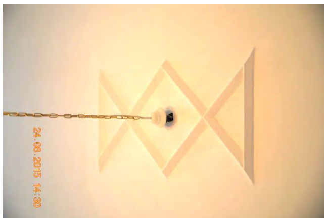
Fot. 5 MEN. Sztukaterie -typ C – zakładana pełna forma dekoracji lub dekoracja posiada ubytki względem bryły w typie B
