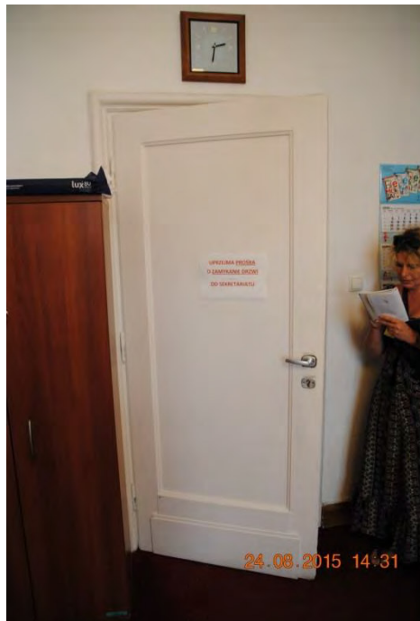
Fot. 11 MEN. Drzwi - widoczne wtórne okucia – klamka.
