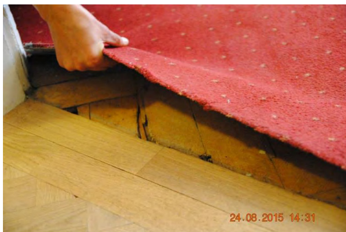
Fot. 13 MEN. Parkiet drewniany widoczne ubytki i uszkodzenia powierzchni klepek.
