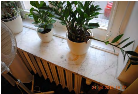
Fot. 2 MEN. Parapet przykład zabrudzenia użytkowego – brązowe zacieki
