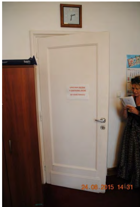
Fot. 11 MEN. Drzwi - widoczne wtórne okucia – klamka.
